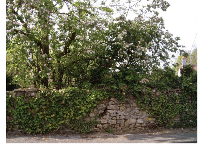
Mur ancien en pierres maçonnées, rue des Ecoles. Envahi par le lierre, il se dégrade par manque d'entretien. On remarque sur la droite deux pierres de couronnement qui tiennent encore en équilibre.
