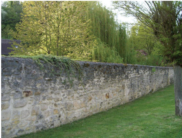
A Noël-Saint-Rémy encore, ces murs très bien entretenus jouent à la fois leur rôle de clôture tout en participant également à la qualité de l'espace public de la rue.
