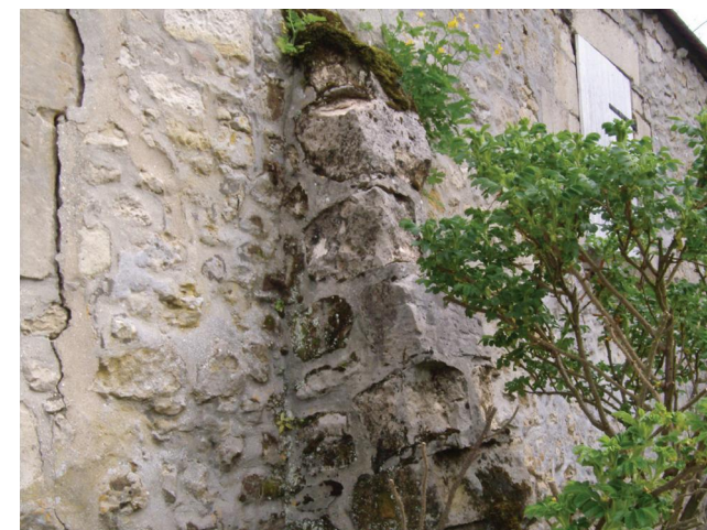
Un contrefort de la ferme du chemin de Carrireuse. Il a été réenduit au ciment, ce qui entraîne une forte dégradation de la pierre calcaire qui s'effrite.
