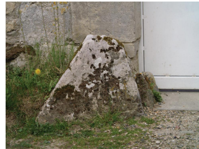
Aux abords des anciennes entrées, les chasses-roues réalisées en pierres sont toujours là pour protéger le bas du pilastre d'entrée. On en retrouve fréquemment au pied des portails des anciennes constructions de Roberval.
