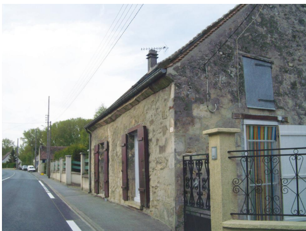
Maison d'habitation ancienne, route de Guidon. Au fil du temps, la chaussée s'est surélevée et atteint désormais l'appui des fenêtres sur rue.
