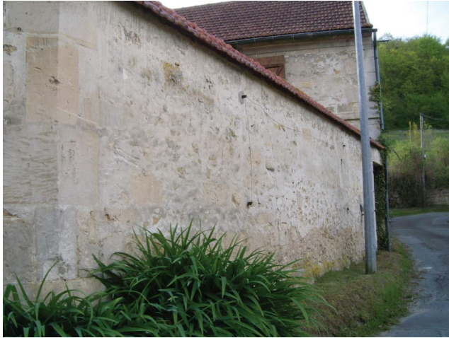
Ce mur ancien rénové et couronné en briques présente des plantations à son pied. Elles offrent un double avantage : être décoratives et limiter la présence d'eau dans le pied du mur en l'évaporant en partie.
