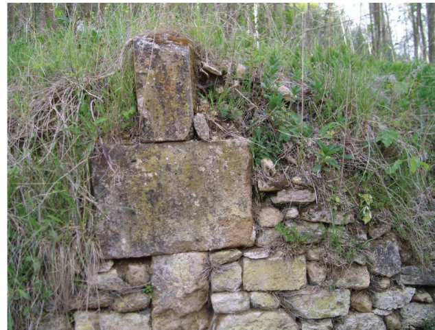
Reste de mur ancien, chemin de Fosse : c'est la partie la plus solide qui a résisté.
