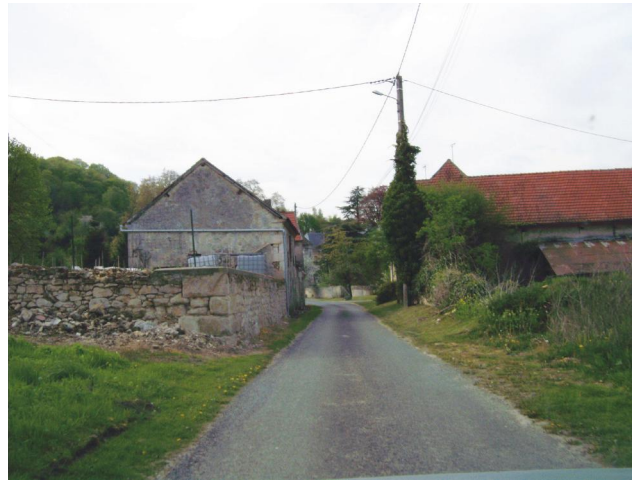
Murs fermant un jardin, en prolongement d'une construction ancienne, chemin de Carieuses. On remarque sur la gauche que le couronnement se dégrade légèrement. La chaîne d'angle est constituée de pierres extrêmement massives.
